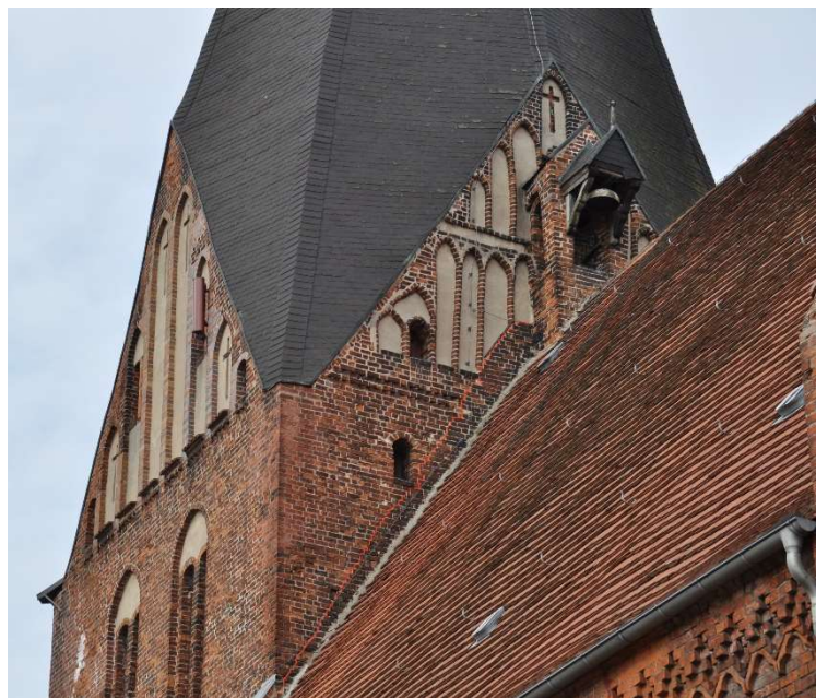
Kirchturm St. Nikolai Röbel (Ost- und Südseite) mit Baunaht (rote Linie) zum westlichen Kirchenschiffgiebel
